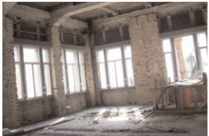
i fatiscenti interni dell'ex edificio della biblioteca regionale
